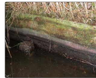
オランダの水路で10年間使用した矢板。
